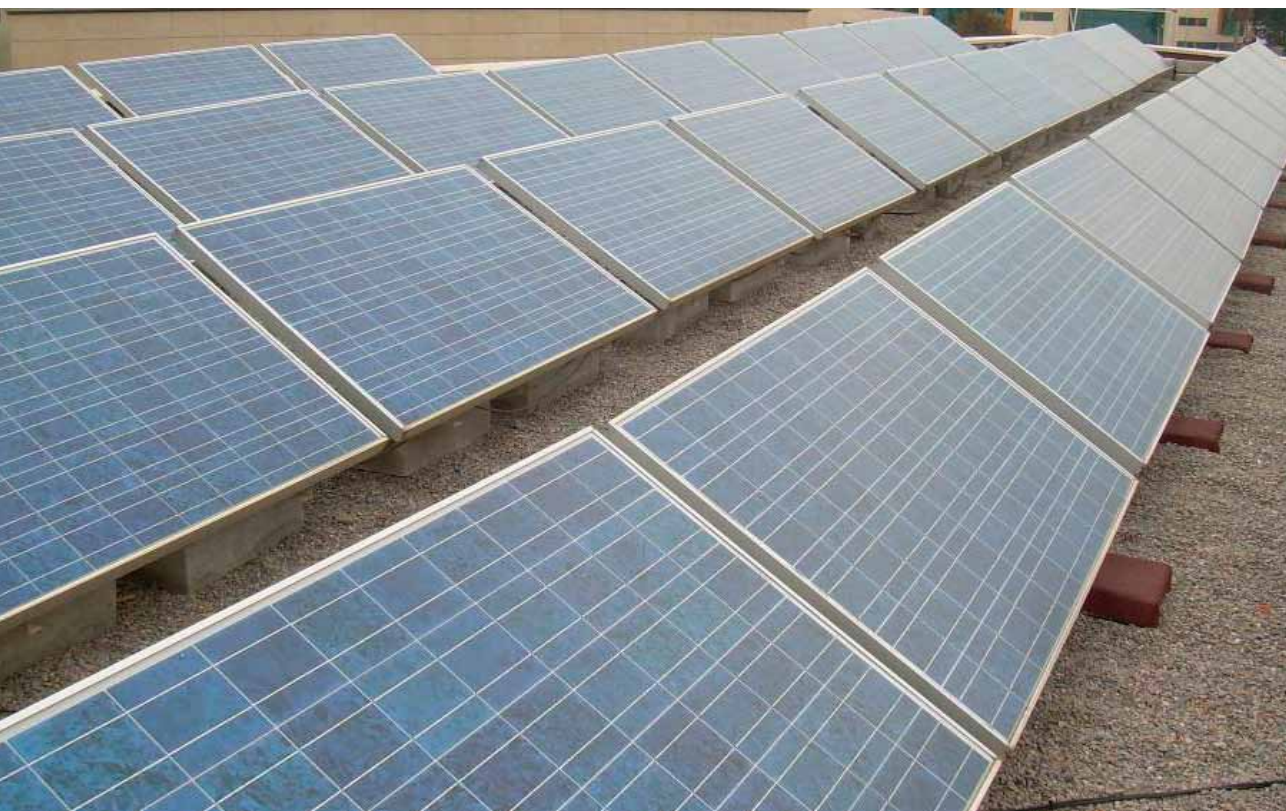
Instalación fotovoltaica en cubierta de edificio. Cortesía SGS.
