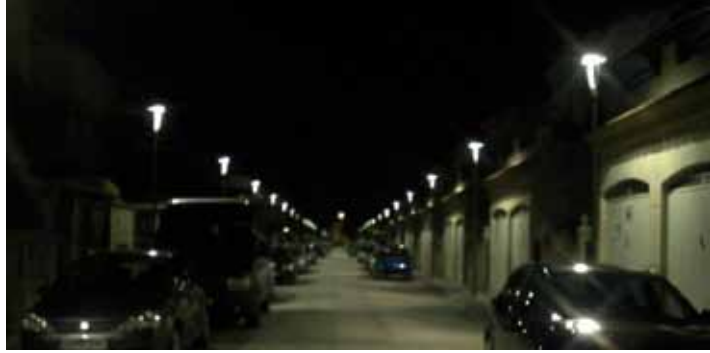
Sistema alumbrado sin regulación de flujo. Cortesía SGS.
