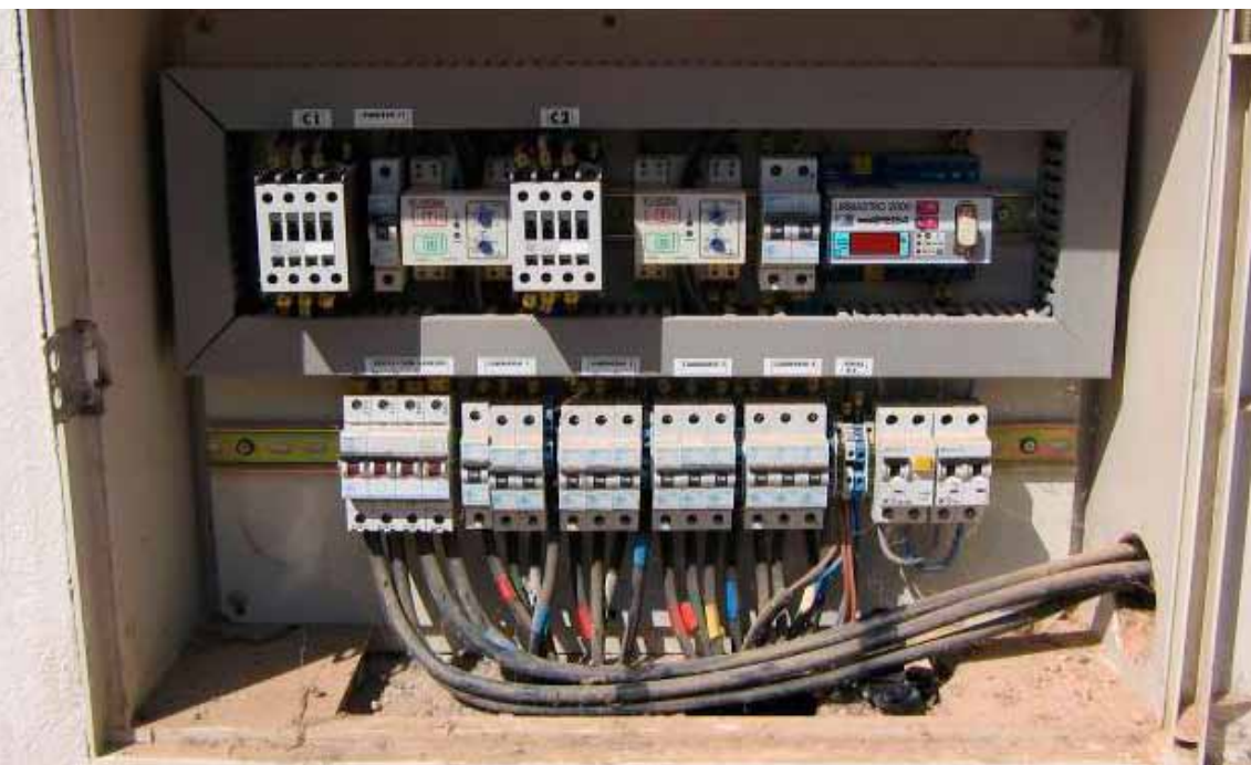
Reloj astronómico instalado en cuadro. Cortesía SGS.
