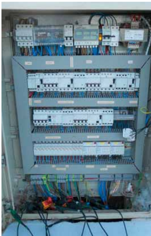
Medición eléctrica en instalación. Cortesía SGS.
