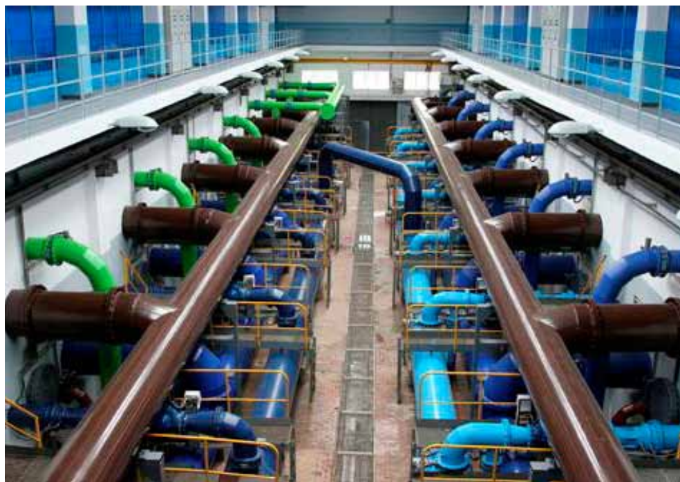
Instalaciones de bombeo. Cortesía SGS.
