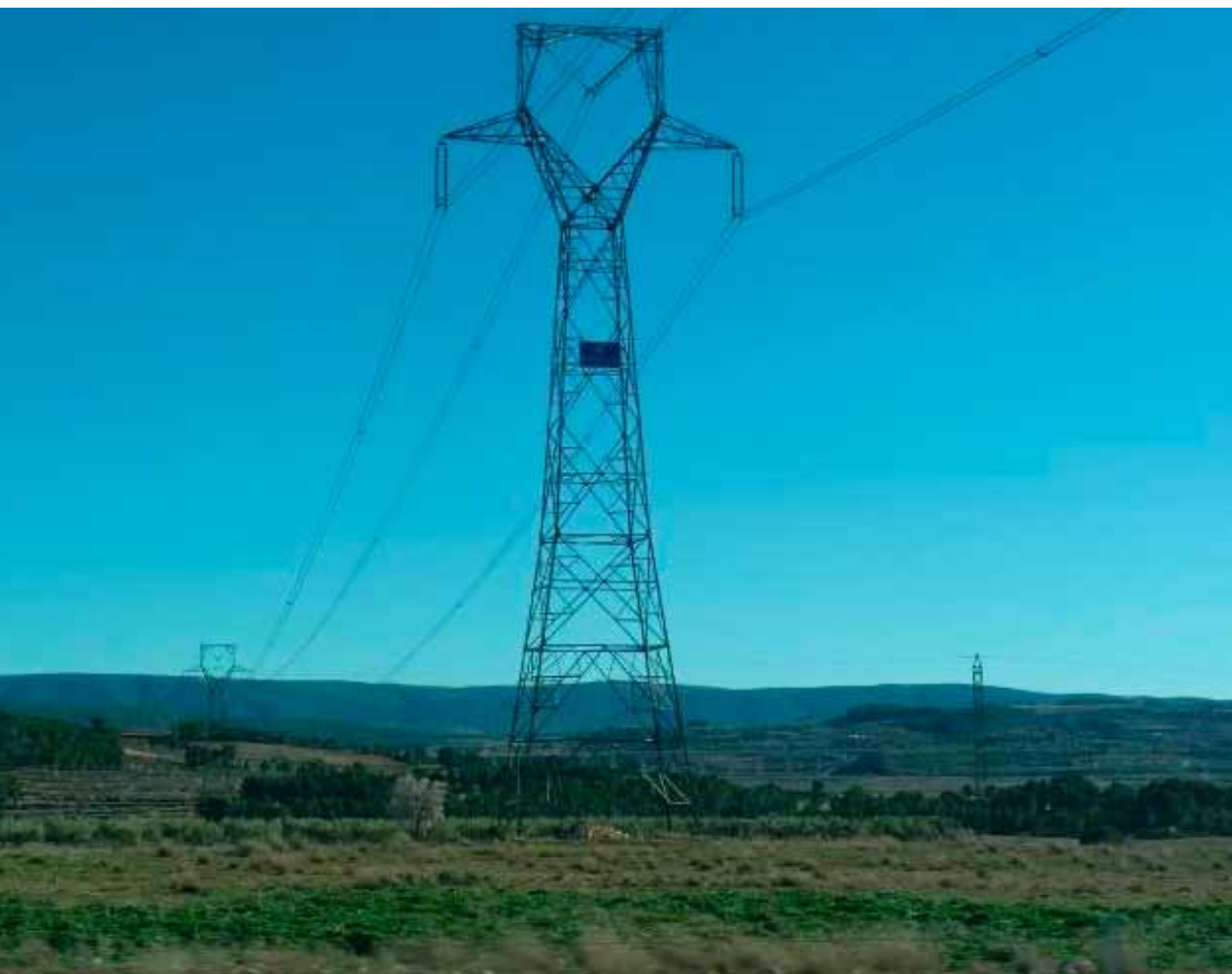
Infraestructura eléctrica. Cortesía SGS.
